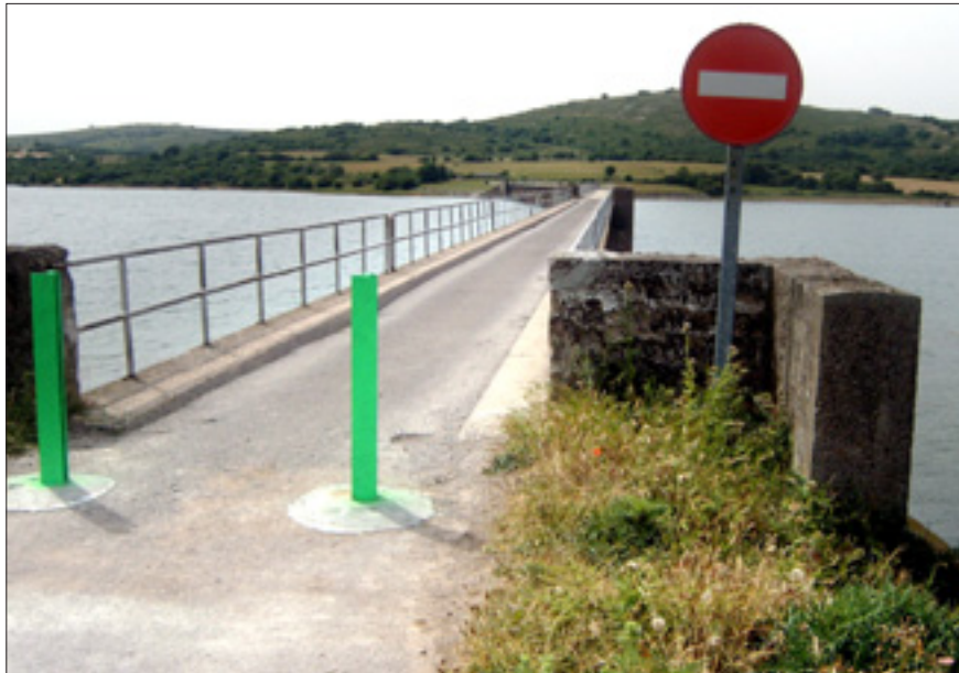
Puente de Orzales cerrado al tráfico de vehículos.
