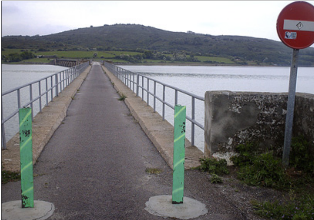
El puente de Orzales tiene prohibida la circulación.
