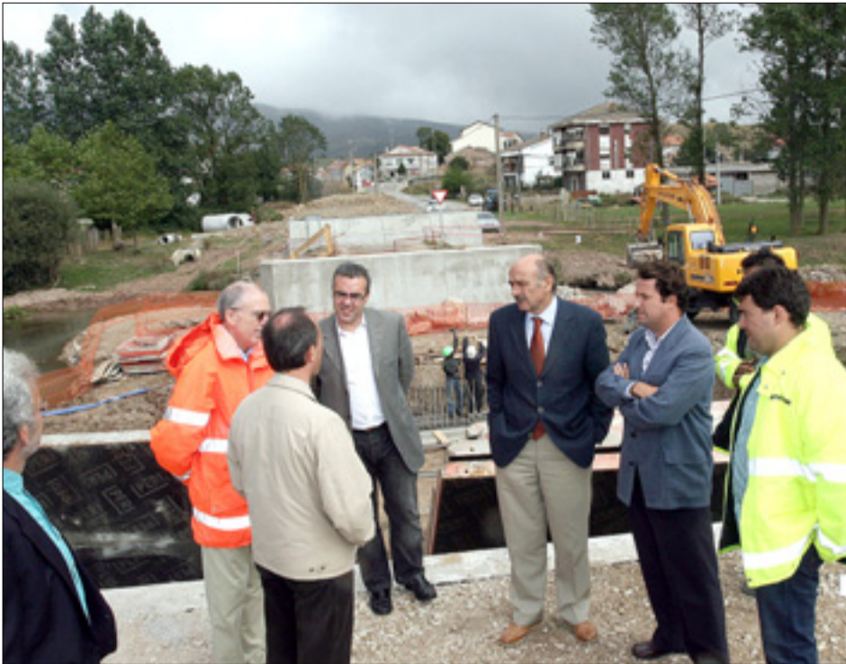
Un momento de la visita a las obras de la carretera Requejo-Bolmir.
