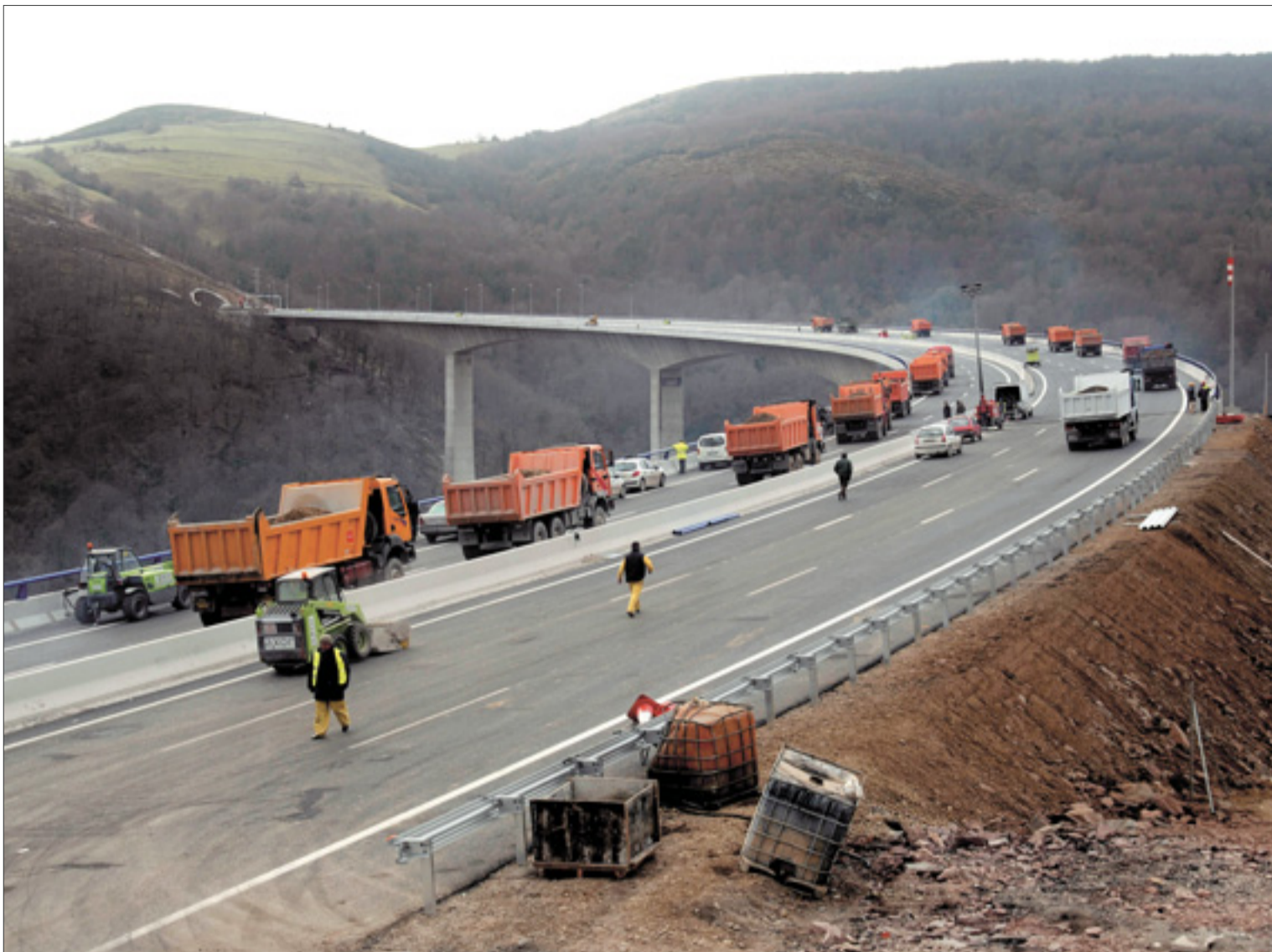
Varios de los caminos que volvieron a trabajar ayer en las pruebas de carga en el viaducto de Montabliz.
