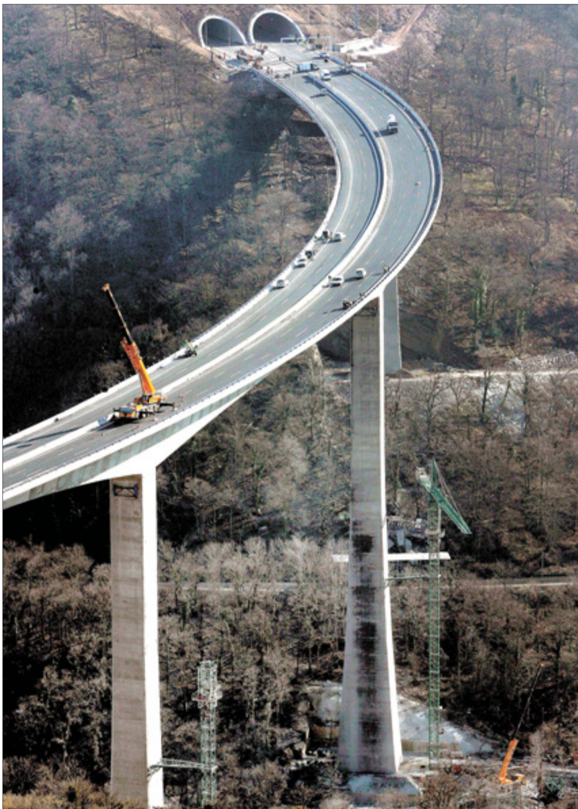
El viaducto de Montabliz, con 145 metros de altura, destaca en el trazado de la autovía y es el mayor de España.
