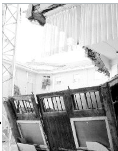
DERRUMBE. Estado en el que quedó el edificio. En la imagen pueden verse cómo quedaron colgadas las cortinas del primer piso. / S. D.
