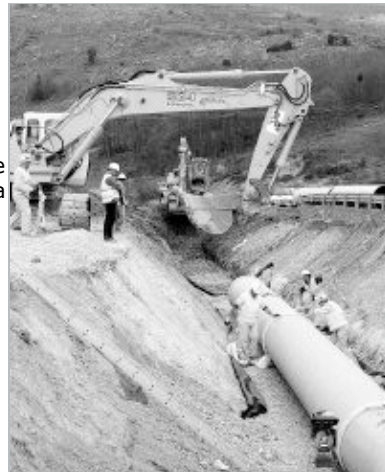
Las tuberías de poliestere reforzado llevarán el agua cuando tenga menos presión. / M. DE LAS CUEVAS
