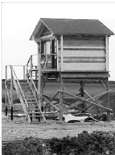
La torre de control permanece a medio construir. / J. L. S.
