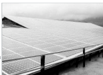
La estación de energía solar fotovoltaica es una instalación fija sobre el tejado. / SANE
