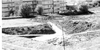
La fase de movimientos de tierra de las obras del Hospital Tres Mares ya han finalizado. / S. D.
