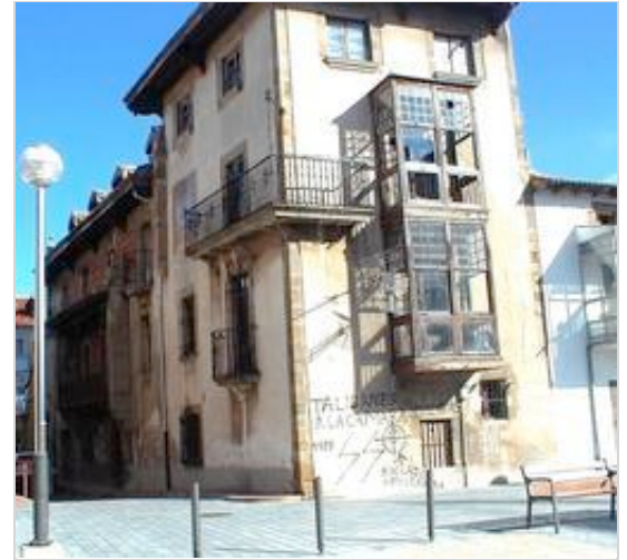
La 'Casuca Ascensión' presenta un avanzado estado de deterioro. / S. D.
