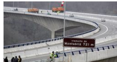
Ayer aún se realizaban los últimos trabajos de limpieza y puesta a punto del viaducto de Montabiz. / ANDRÉS FERNÁNDEZ
