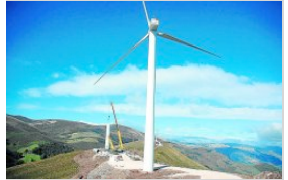
Obras en el parque eólico de Cañoneras, en la localidad cántabra de Soba. /DM
