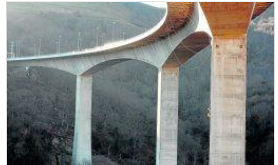
Los cables se conectarán a las barandillas del viaducto. / J. L. SARDINA
