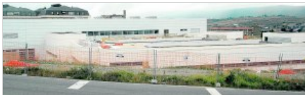
Estado actual de las obras del hospital Tres Mares de Reinosa. / JAVIER
