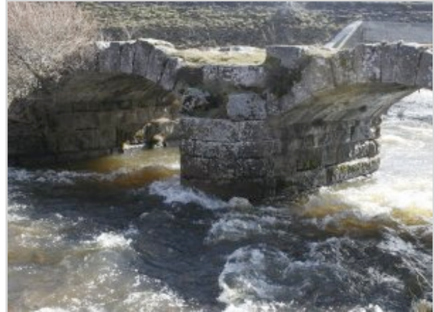
El agua ha arrancado de la base del puente las piedras de una de las bóvedas. :: SARDINA
