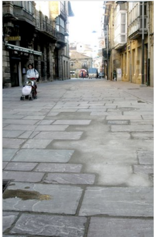
Los parches de cemento sustituyen las losas de la calle Mayor. :: J. D.
