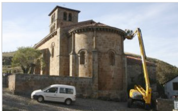
Los trabajos de reparación de la Colegiata de Cervatos ya han comenzado. :: J. L. SARDINA
